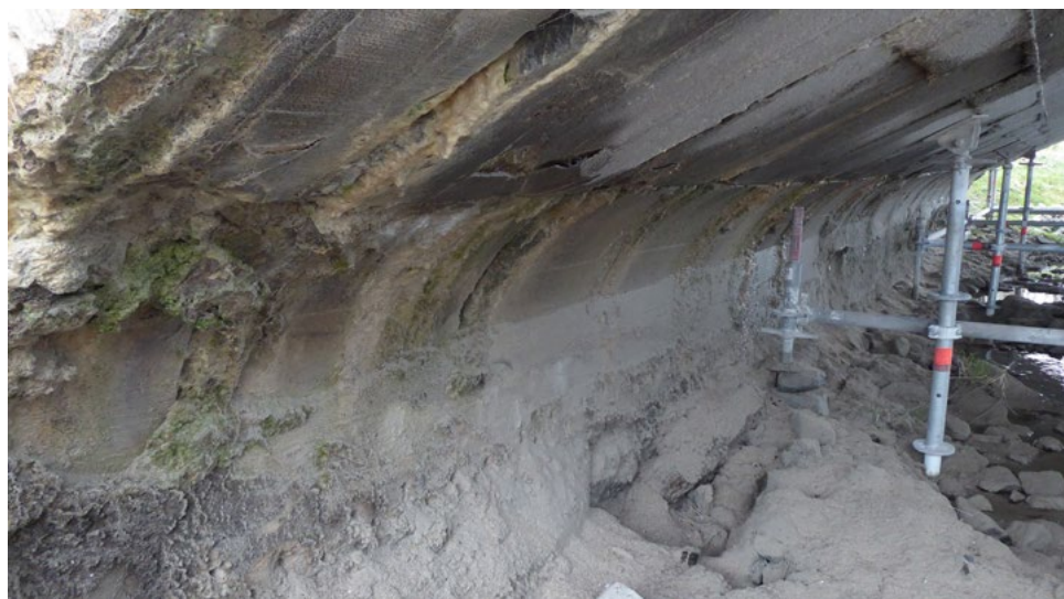
4. Wykwity solne widoczne na filarze i sklepieniu przęsła środkowego – stan przed konserwacją. Fot. M. Helińska-Grodź.
